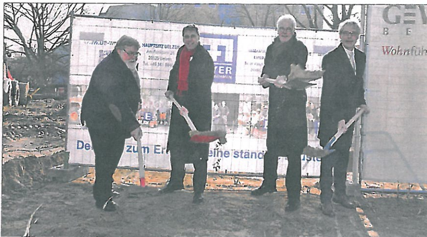
GEWIWO-Architekt Bernd Richter, Stadtrat Martin Lambert, Gewiwo-Vorstand Rüdiger Brombach, Holger Horn, GF Bauunternehmen Willi Meyer (v.l.n.r)
